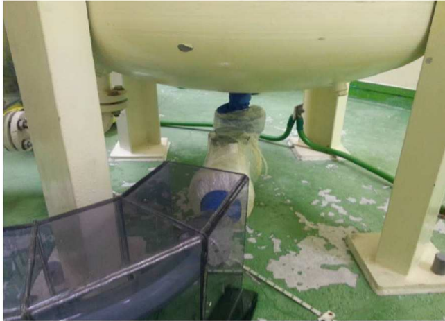
[사진 1] 누출이 발생한 불산탱크 하부 모습
