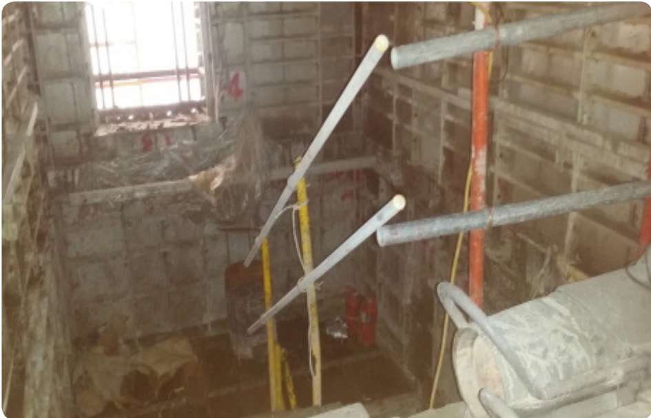
[사진2] 계단참에 설치된 드럼 난로
