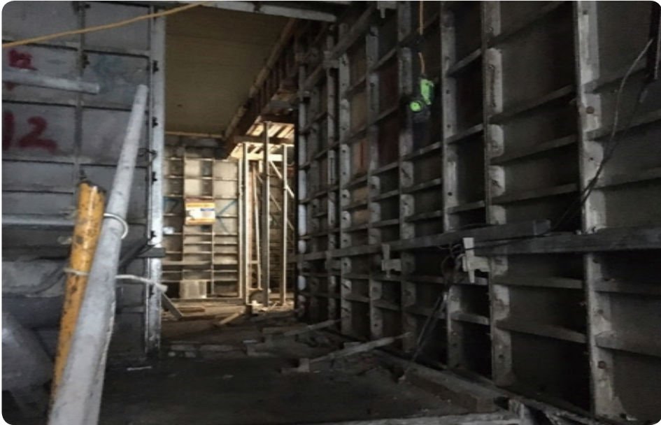
[사진3] 재해발생 현장 입구
