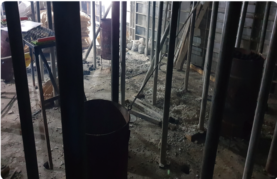
[사진2] 재해발생 현장(옥탑 2층) 내부
