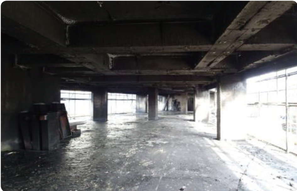
[사진2] 화재발생장소 (1층 천장 보온재 전소)
