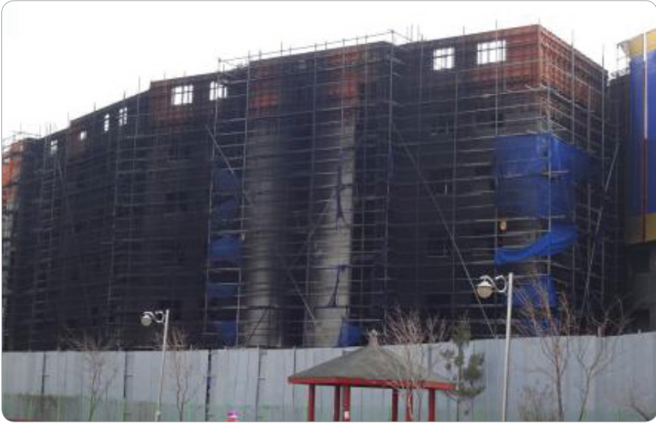
[사진1] 재해발생현장 전경(외부 비산방지망 소실)
