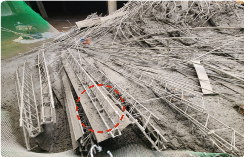
[사진2] 붕괴되어 굴착면에 떨어진 테크플레이트
