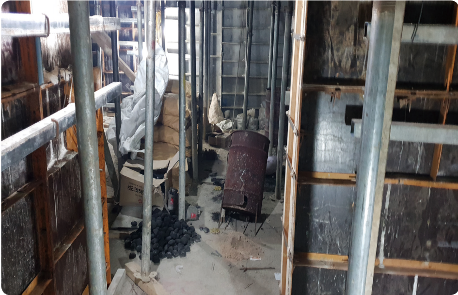
[사진1] 재해발생 현장 전경
