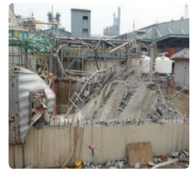
폐수 환경설비 구축공사 중 폭발 ('15. 7. 3 사망6, 부상1)
