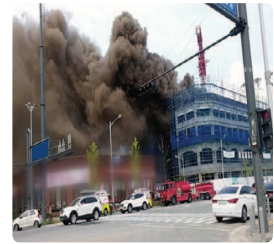
근린생활시설 신축공사 화재 ('16. 9. 10 사망4, 부상2)
