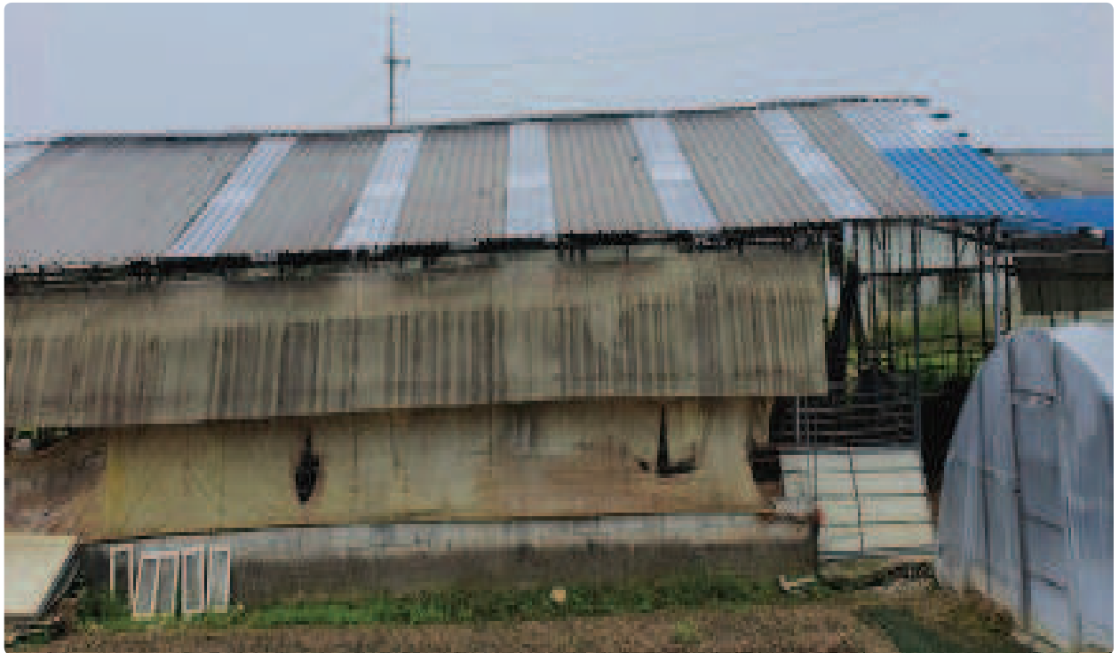
[사진1] 재해발생 현장전경
