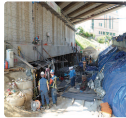
복선전철 교량 하부보강 중 LPG폭발 ('16. 6. 1 사망4, 부상10)
