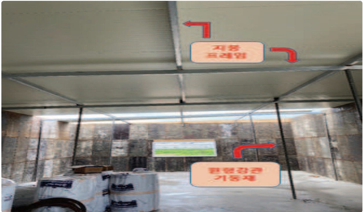
[사진1] 재해발생 현장전경
