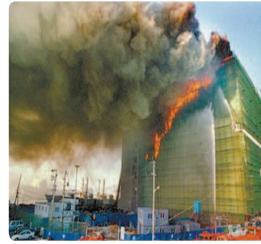
부산 냉동창고 신축공사 화재 ('98. 10. 29 사망27, 부상16)
